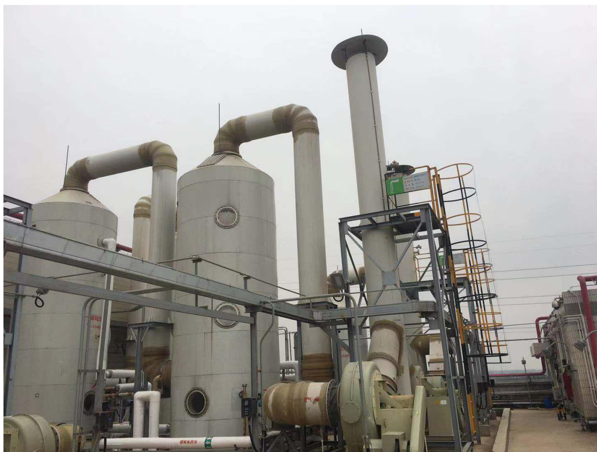
图 4.1-5 该项目精馏废气“二级水洗+二级碱洗”塔及排气筒
