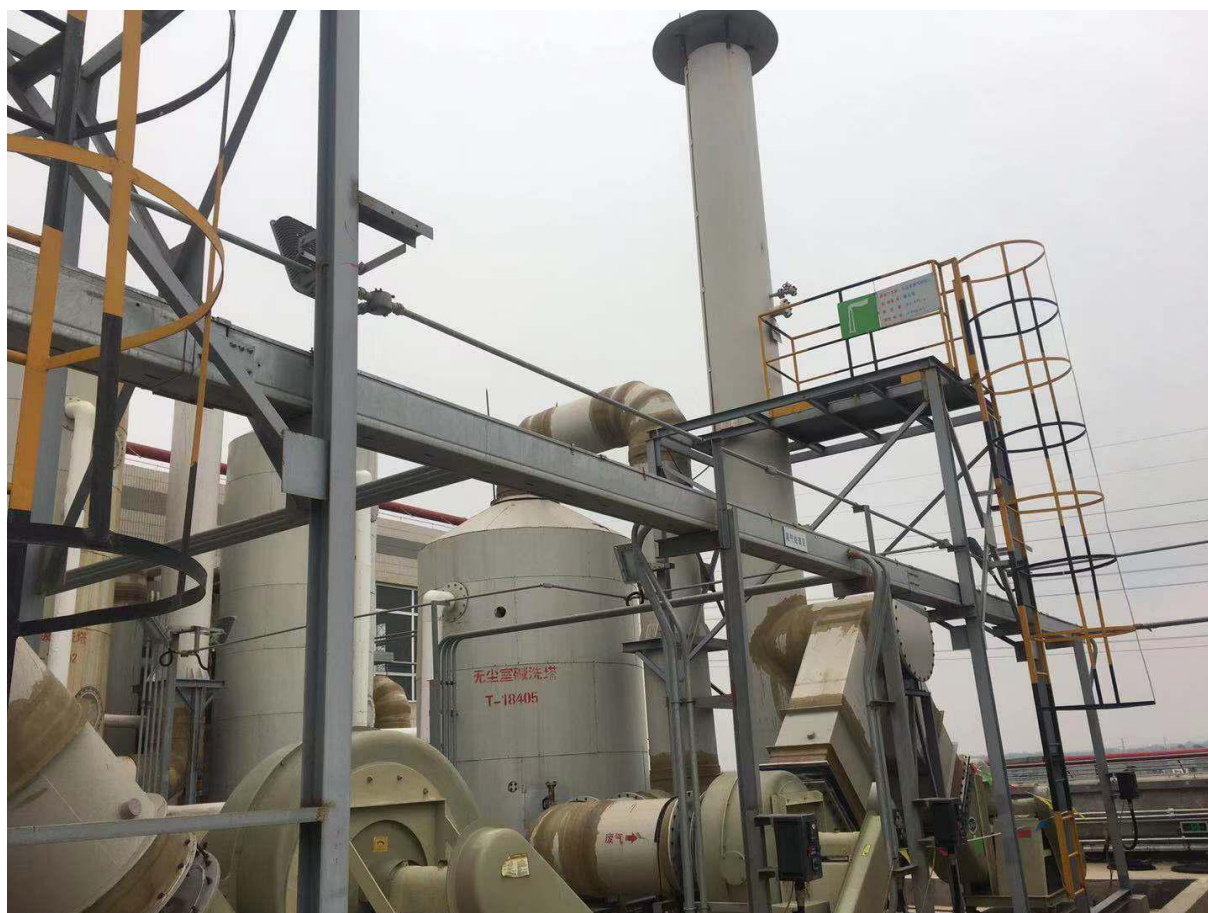
图 4.1-4 该项目无尘室废气碱洗塔及排气筒
